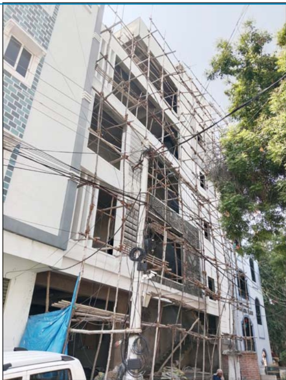
కమల ప్రసన్న సగర్ అక్రమ నిర్మాణం
